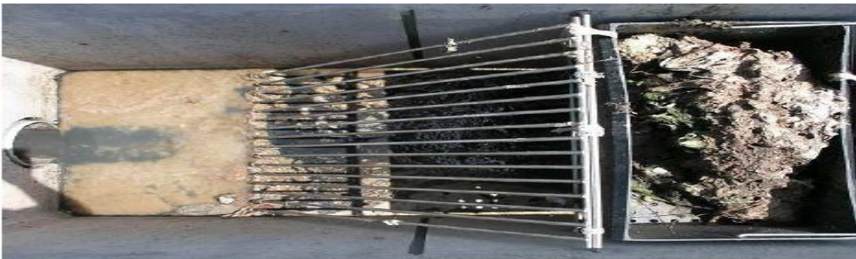
Figure 4 : Dégrillage manuel par grille oblique en acier inoxydable [8] .
