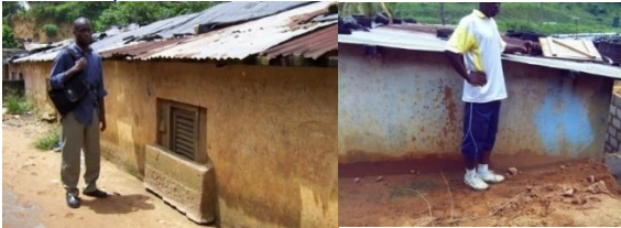
Figure 2. Maisons construites en bas de pente, englouties par la boue, dont les toitures ne sont plus qu'environ à 1 m du sol, Agban village, mai 2005 (Photo N'BRI B. E)
