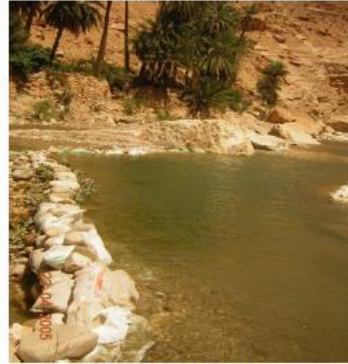
Figure 06: La déviation de l'eau d'oued avec des diguettes à bas de sacs de sable à Mchounech
