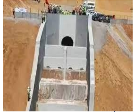
نهاية اشغال تحويل المياه من حوض سبو إلى حوض أب رقرق المياه ووضع الانابيب الفولاذية
