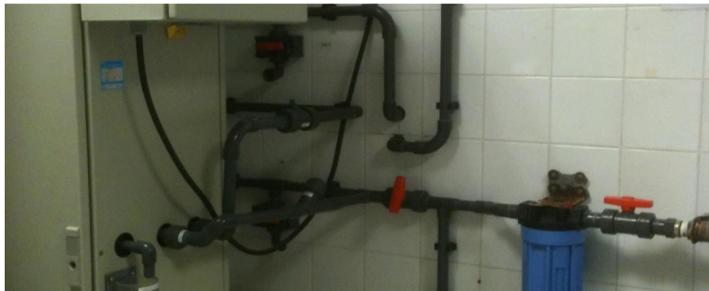
Figure 03 : Unité d'osmose inverse et le pré filtre [4]
