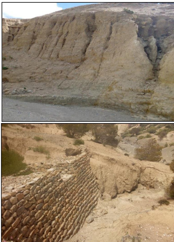
Figure 5 : Formes d'érosion hydrique du bassin d'oued Souani. comblé de sédiments.
